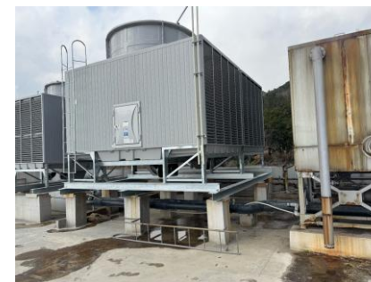
(霧島国際ホテル、敷地内で自噴している温泉蒸気を使用した空調設備)
