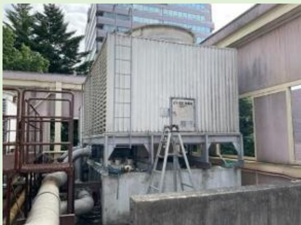
（高温水ヒートポンプ導入前）
