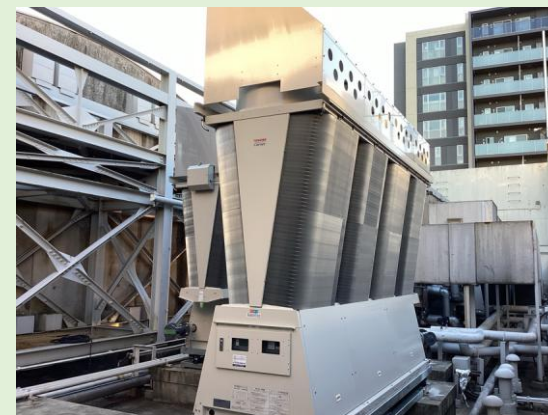
（空冷ヒートポンプチャラー導入後）
