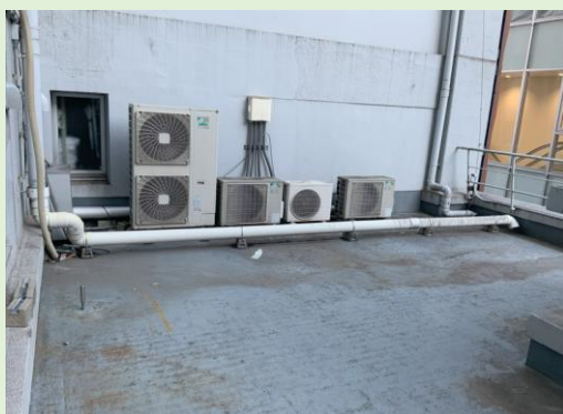
(ヒートポンプ給湯機導入前 -ホテルマイステイズ五反田駅前)
