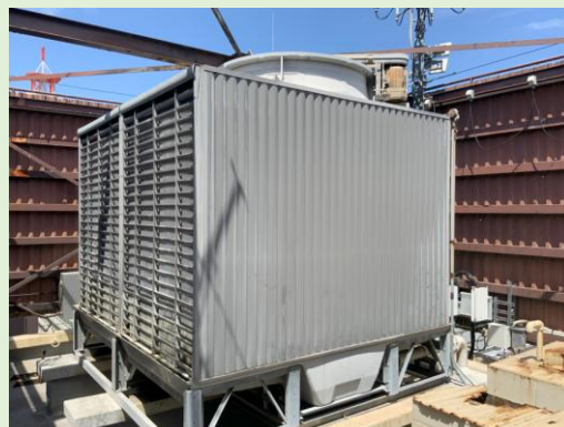
(空冷ヒートポンプチラー導入前 -ホテルマイステイズ名古屋栄)
